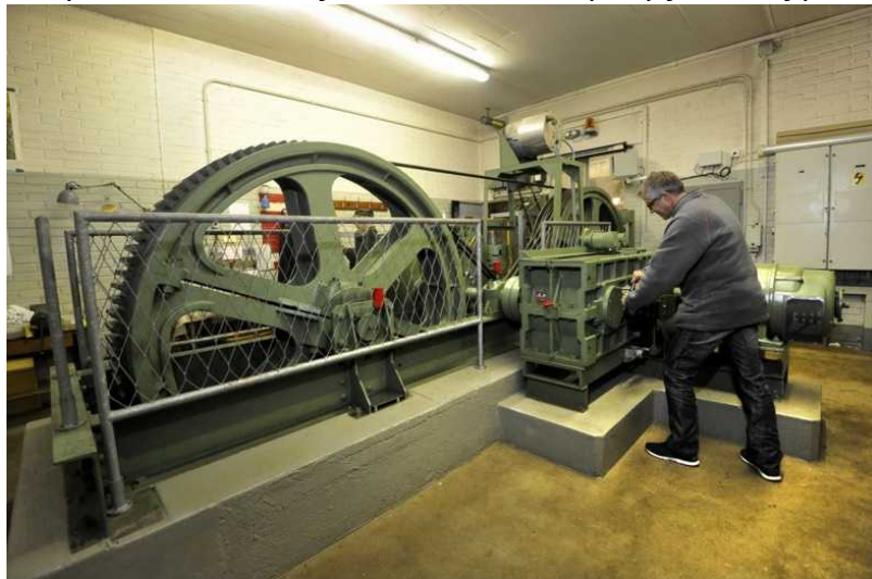
Зал управления фуникулером (lenouvelliste.ch)
